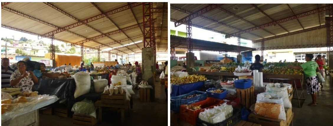
Figuras 7 e 8: Fotos da feira Cidade Baixa, na primeira é possível observar as falhas da cobertura do galpão. (Fonte: Próprio Autor)
